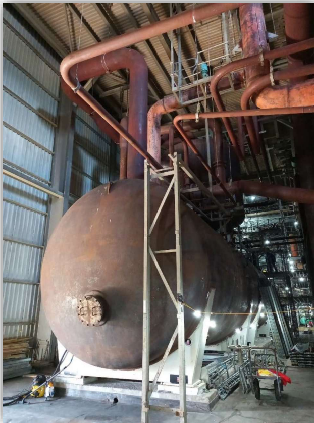
Ffotograff 9 Tanc dadawyru a phibellau cysylltiedig ar ôl tynnu deunydd inswleiddio sy'n cynnwys asbestos a thynnu grisiau Haki.
