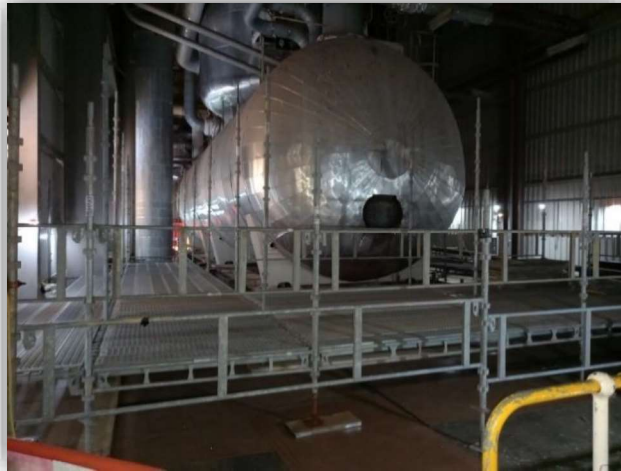
Ffotograff 5 Tanc dadawyru gyda phibellau cysylltiedig ag inswleiddiad sy'n cynnwys asbestos.
