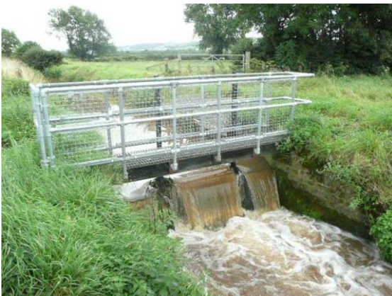
G. Stop log weir
