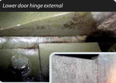
Lower door hinge external
