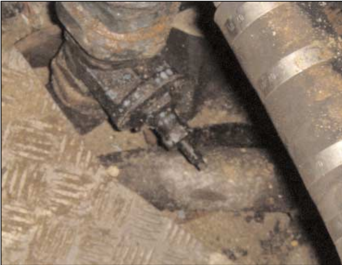
Robinet d'aspiration principal de la cale
