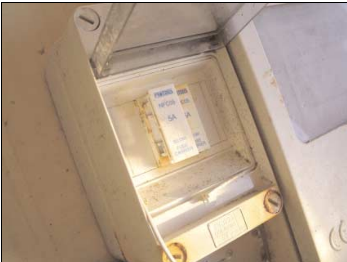
Boîte à fusibles de la cale et des avertisseurs d'incendie
