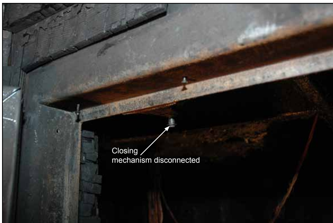
Galley fire door frame
