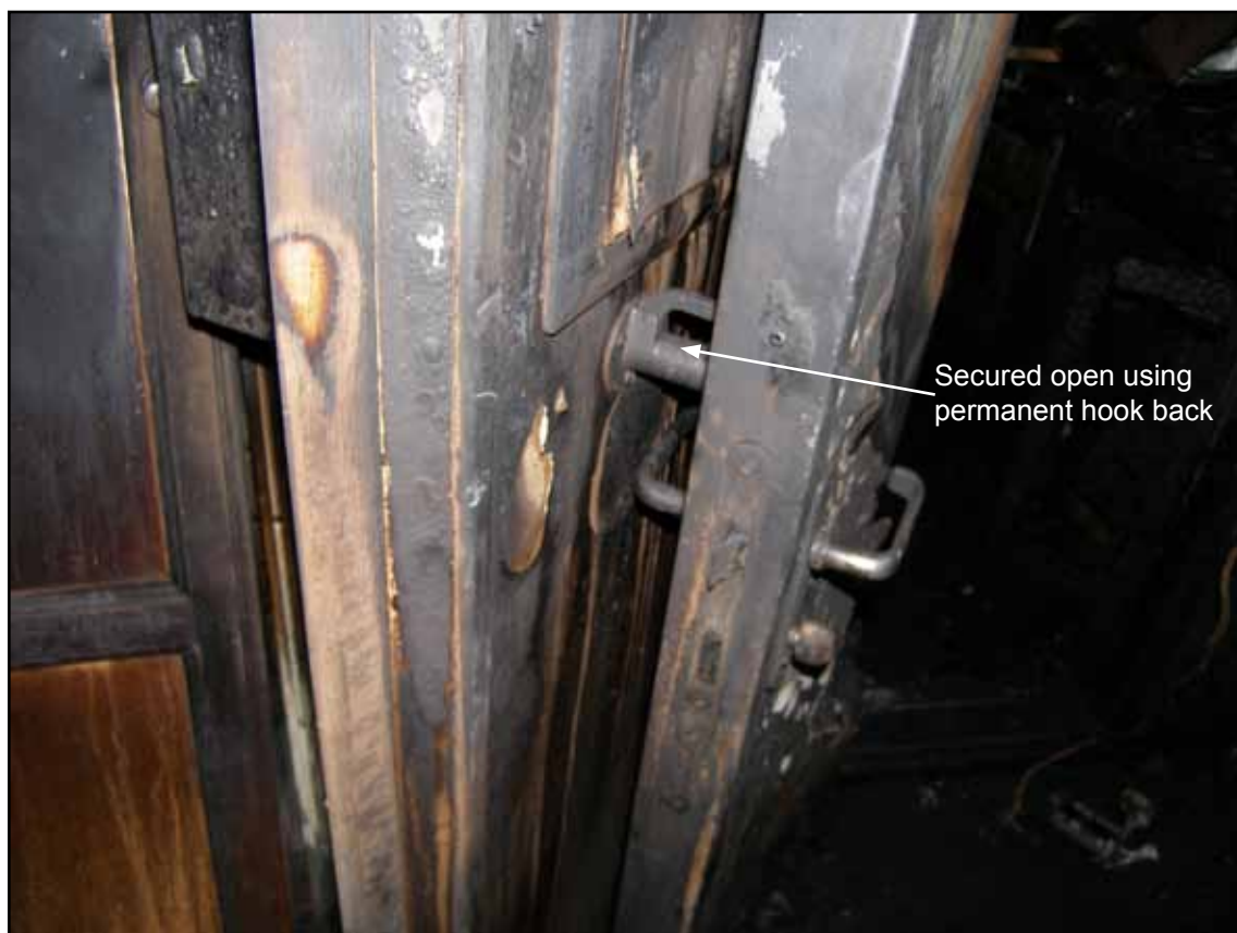
Galley fire door - open position
